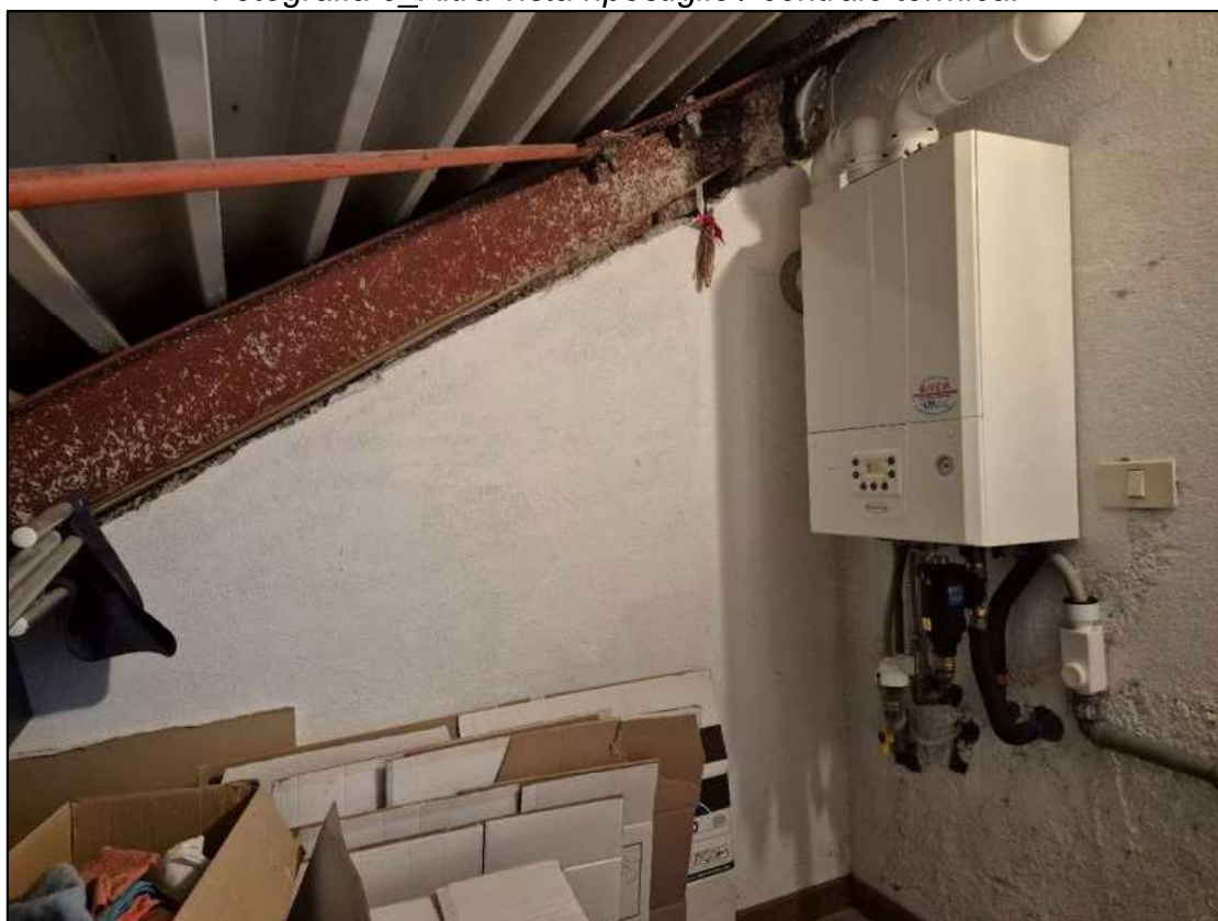
Fotografia 9_Altra vista ripostiglio / centrale termica.
